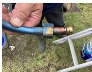
作業中(破損箇所)
