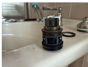
作業中(破損部)
