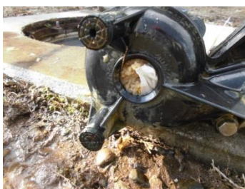
給水口に異物つまり
