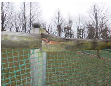
横木破損状態
