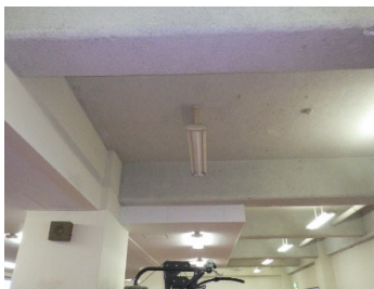
蛍光ランプ取替前
