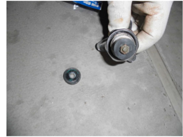
不良パッキンと交換取付後パッキン
