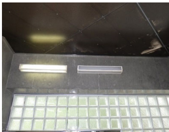
蛍光ランプ取替前
