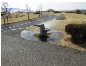
立水栓 破損状況
