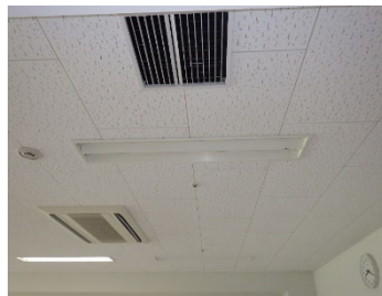
第 1 会議室蛍光ランプ取替前
