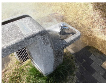
立水栓破損状況(拡大)
