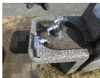
破損器具と交換器具
