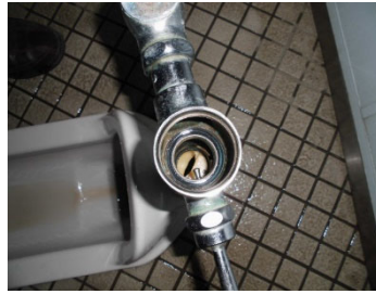
不良箇所バルブ内部
