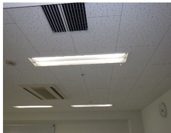
第 1 会議室蛍光ランプ取替後
