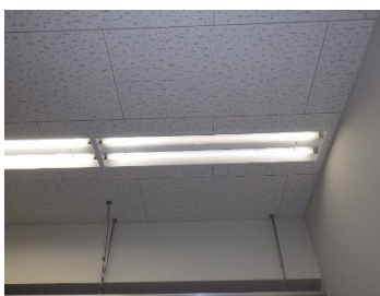
医務室 蛍光ランプ取替後
