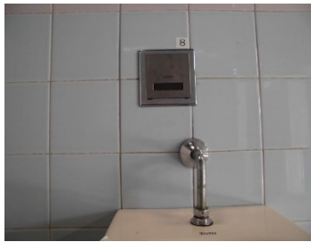
不良感知フラッシュバルブ部分
