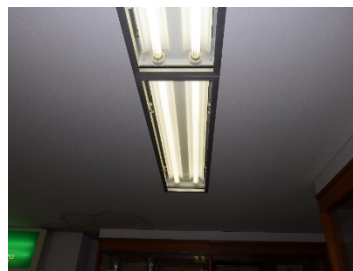
ロビー蛍光ランプ取替後
