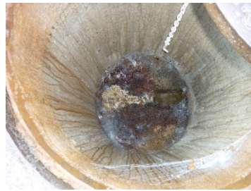
南側 汚水枥②つまり状況
