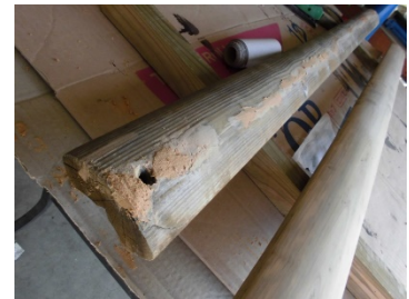
座板 ひび割れ パテ埋め
