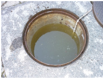
南側 汚水枥①つまり状況
