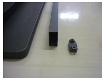
溶接部 破損拡大
