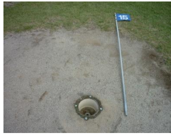
破損部分拡大
