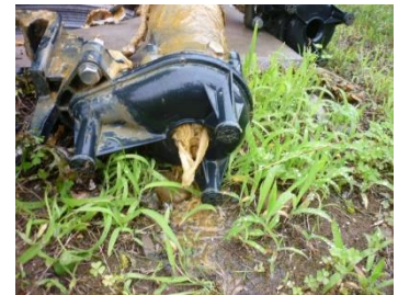
2 号ポンプが異物吸い込み
