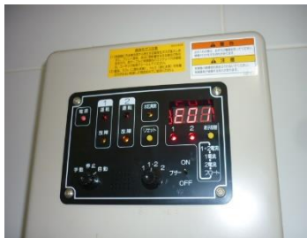
汚水槽制御盤
