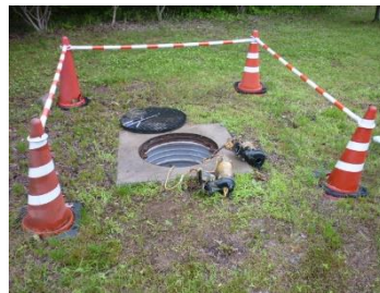
汚水槽ポンプ確認
