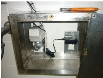
電源アダプター交換
