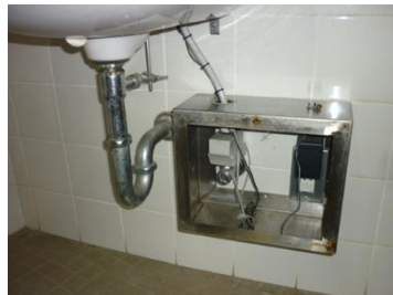
電源アダプター故障
