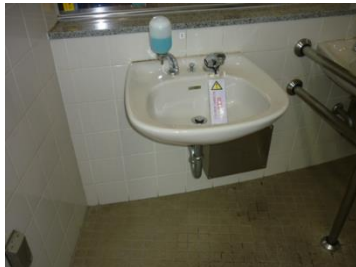
手洗い器自動水栓の水が出ない
