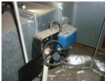
ダンパー操作器より異音確認
