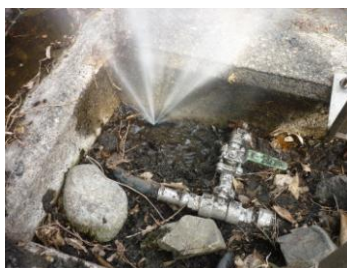
高圧ホース破損部確認
