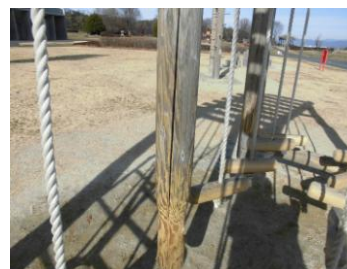
他亀裂箇所着手前
