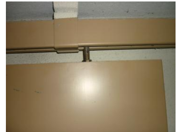
吊りボルト部分に緩みあり
