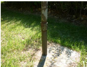
スプリンクラー立上げ配管が 傾いている
