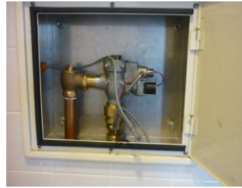
故障フラッシュ弁
