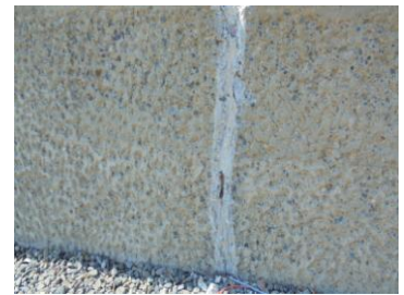
壁泉ひび割れ部
