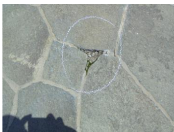
円形流れ 底目地劣化
