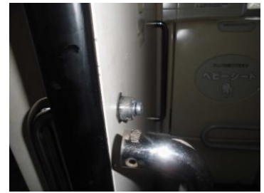
ネジ緩み状況
