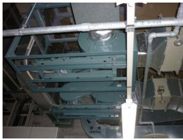
天井吊り排気ファン
