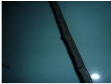
劣化状況拡大
