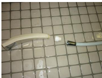
漏水修理箇所
