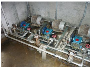
オイル交換ポンプ 3 台
