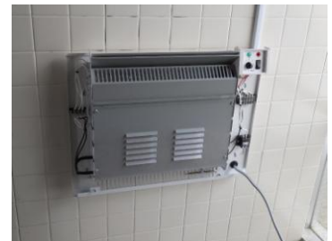
パネルヒーター取付状況
