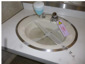
排水栓が上がらず排水できない
