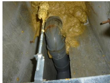
雨水縦樋より水漏れ確認
