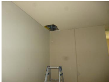
天井破損部開口して確認
