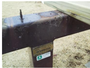
ビス腐食状況
