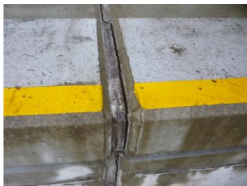
ひび割れ確認
