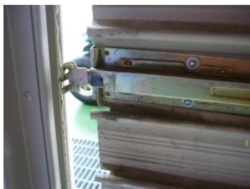
ラッチ破損箇所
