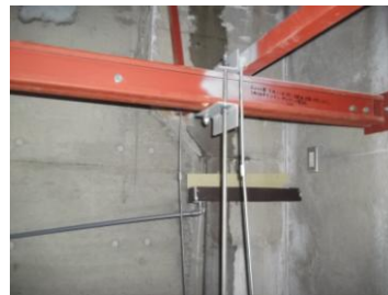
受樋・排水管取付 上部観覧席からの漏水状況
