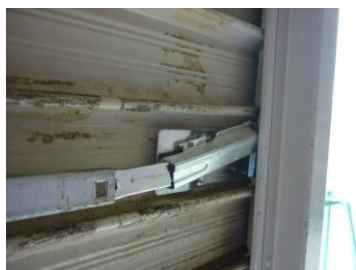
ラッチ破損状況
