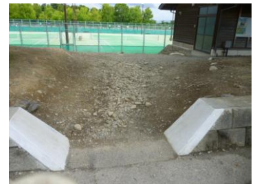
石の散乱状況 1
