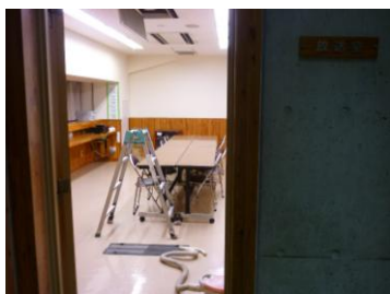
やまびこドーム放送室エアコン
