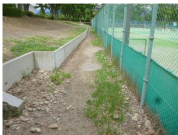
石の散乱状況 2
