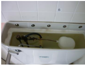
故障したボールタップ
