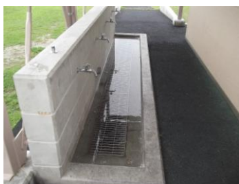
北側足洗場 グレーチング面まで満水
