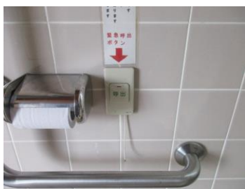
4号トイレ呼出 押しボタン 取替前
