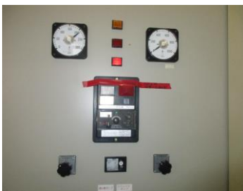
QB 低圧動力用 LGR 取替前
