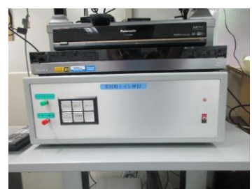
アルウィン 呼出装置設置 (南管理棟・8～11号トイレ)
