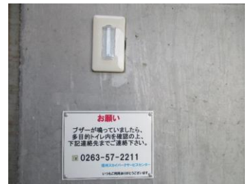
4号トイレ呼出表示灯 取替後
