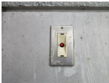
4号トイレ呼出表示灯 取替前
