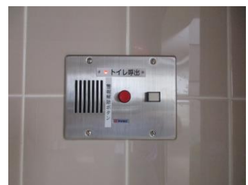
4号トイレ呼出 呼出表示装置 取替後
