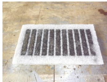
吸込み口フィルター汚れ確認
