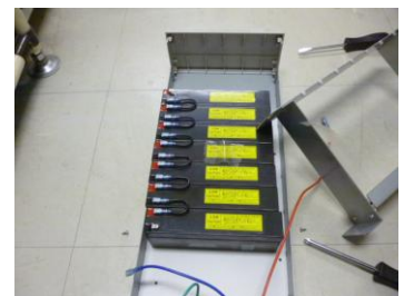
内部バッテリー
