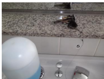
ポップアップ金具内ゴミの詰り 状況
