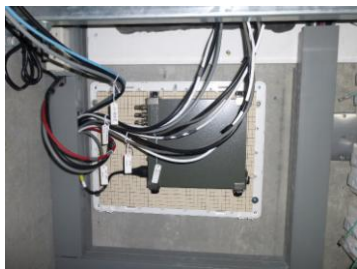
中継器・配線状況
