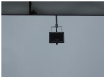
ゲート看板ランプ取替前
