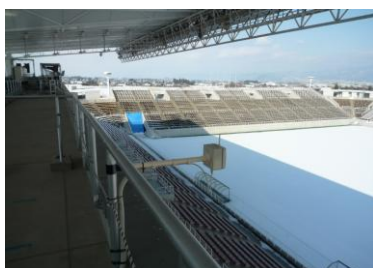
移設後のアンテナ①
