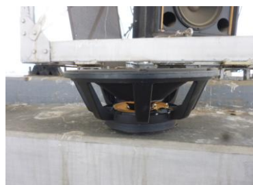
破損状況①
