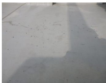
鳥害(糞)被害状況
