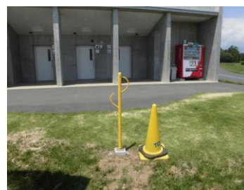
24号トイレ前ドッグステイ設置
