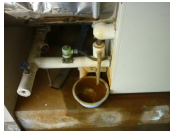
溢れ管よりオーバーフロー
