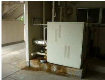
浴室用給湯ボイラー
