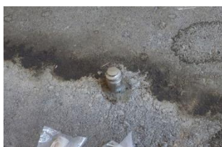
作業前(緩衝材が取れている)
