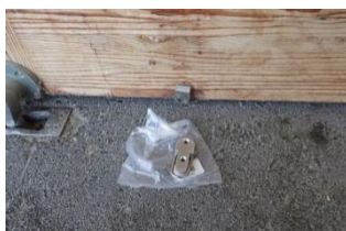
作業前(フックが折れている)
